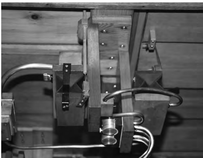
Zwei der drei voneinander unabhängig arbeitenden Schweller-Steuerungen. Links der „Akzent“-Balg (Spur 42), rechts der Balg von Spur 87.
